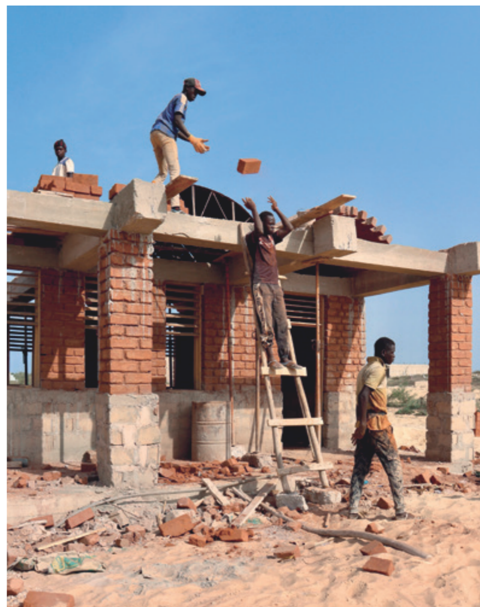
Dues imatges de la construcció del Lycée Niague a Dakar, Senegal (maig 2024). Autor: Gerard Lizana Vilaseca.
